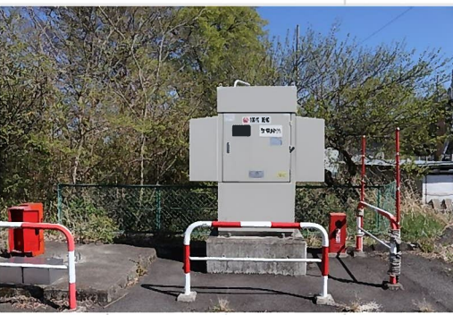
②指令センターの発電機を撮影
